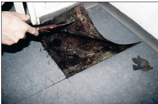
Skimmelsvamp under gulvbelægning (Kilde www.skimmel.dk )
